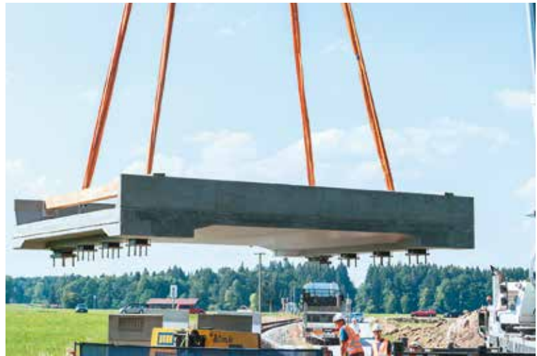
Brücken bauen im Studium Bauingenieurwesen: Eisenbahnbrücke aus ultrahochfestem Beton. Bild: Uli Benz/TUM
