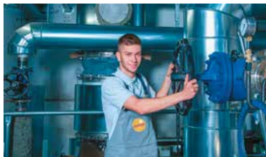
Abb. 2: Die Anlagentechnik ist das Herz eines Gebäudes. Foto: ENTEGA Ausbildung
